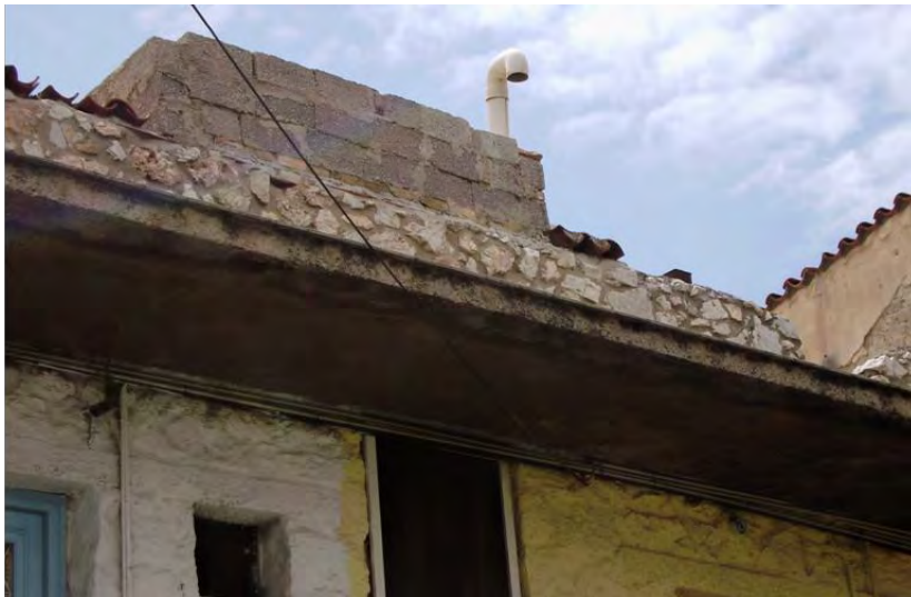
Πρόσθετο κτισμένο τμήμα με τσιμεντόλιθους στην ταράτσα
